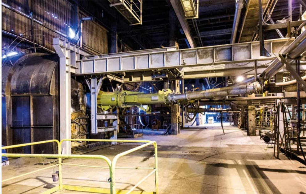
↑ Tehase kahele pöördahjule on paigaldatud mitmekanaline põleti vedelate ja tahkete alternatiivkütuste põletamiseks.
